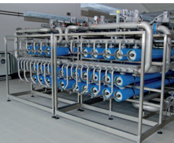
Abb. 3: Modulanordnung bei der Nanofiltration
