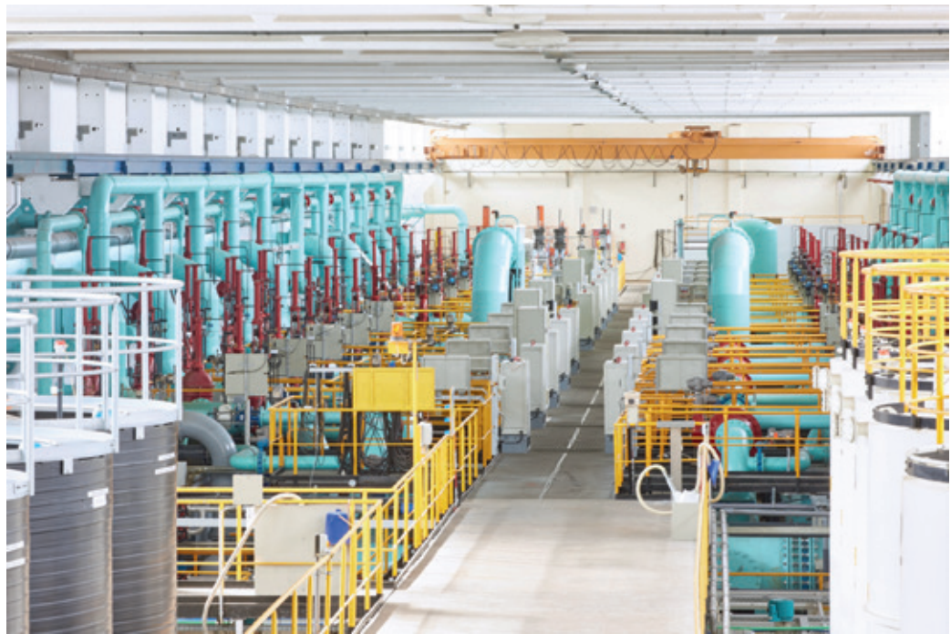
Abb. 2: Blick in die Maschinenhalle der Wasseraufbereitung des Wasserwerks Burkersdorf
