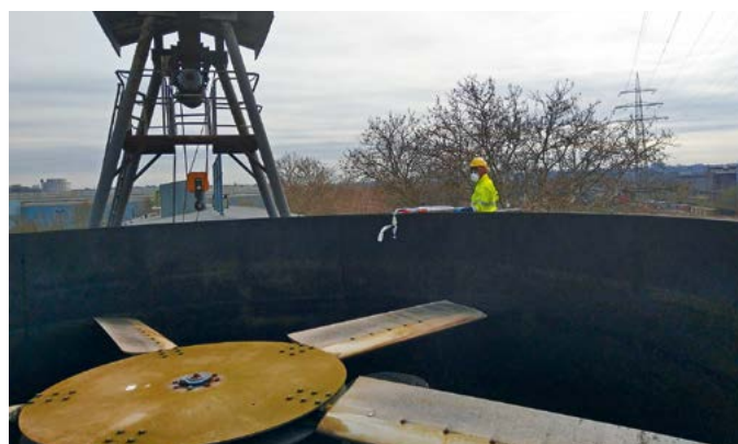
Aerosolprobenahme zur Legionellenuntersuchung an einer Verdunstungskühlungsanlage
