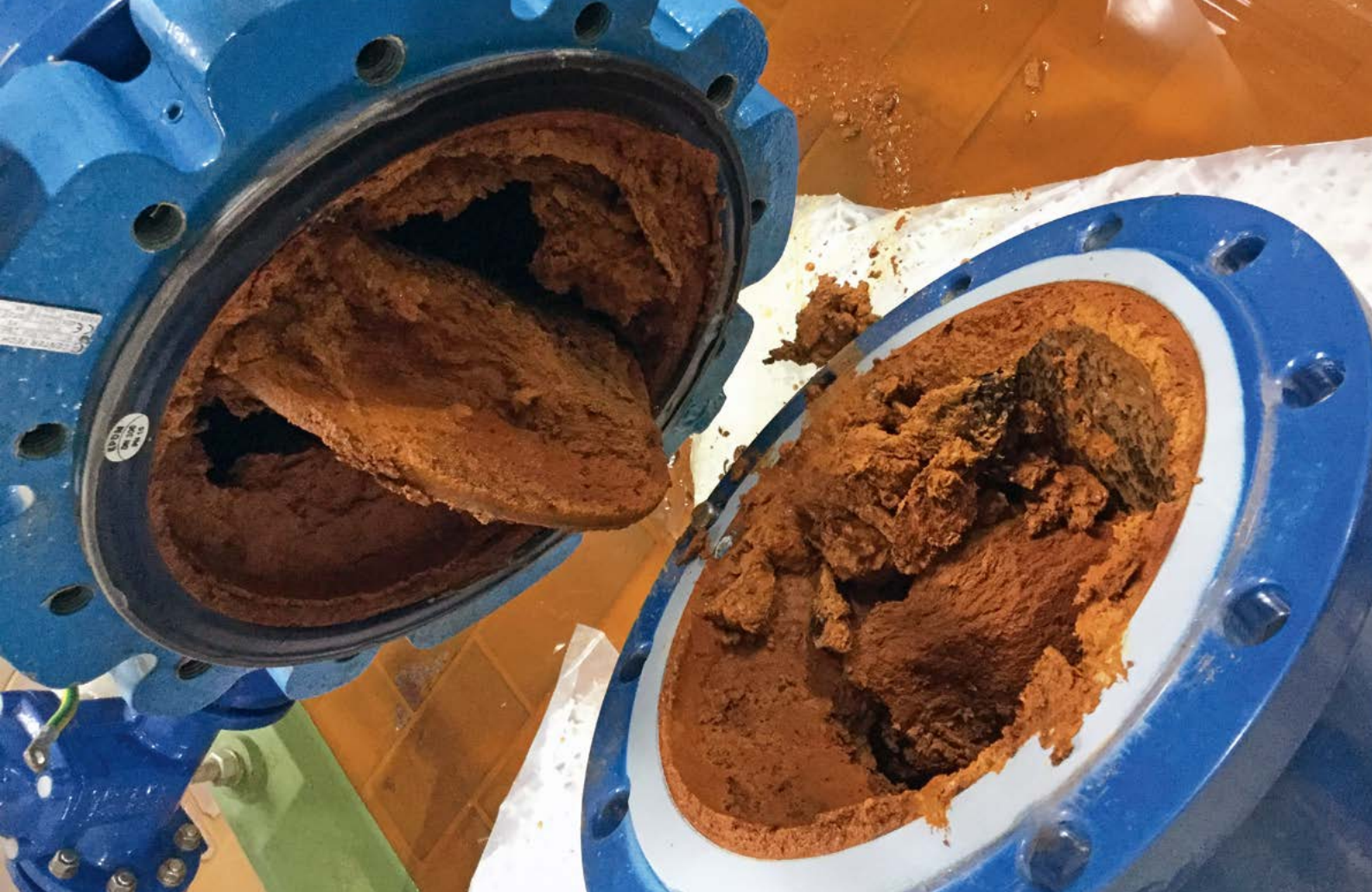
Abb. 2: Eisenoxidablagerungen an der Absperrklappe nach Oxidator
