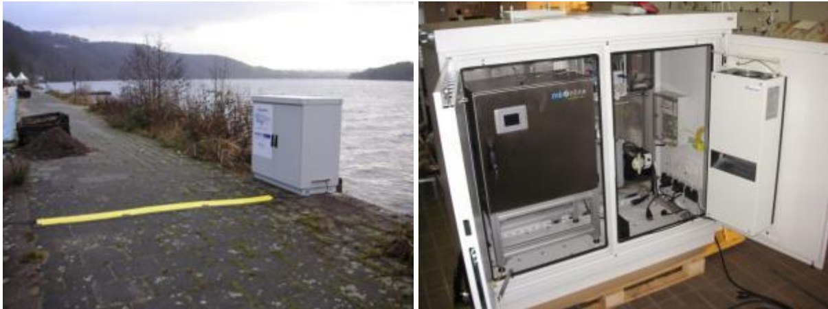
Abbildung 73: Aufstellort des Colilert-Systems am Seaside Beach (links) und Blick in den Messschrank (rechts)
