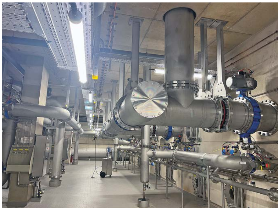
Innenansicht der neuen Trinkwasseraufbereitungsanlage
