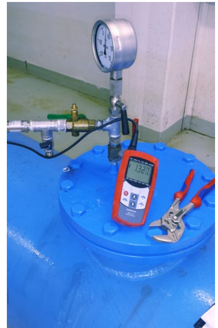
Es gibt viele Stellschrauben im System zur Effizienzoptimierung
